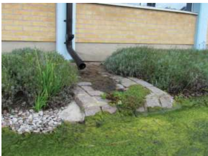
Figur 25: Regnvand ledes i en tæt rende bort fra huset til nedsivning i græsplænen. Foto Orbicon, Augustenborg, Malmø.
